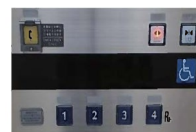
車椅子用エレベータ 操作盤
