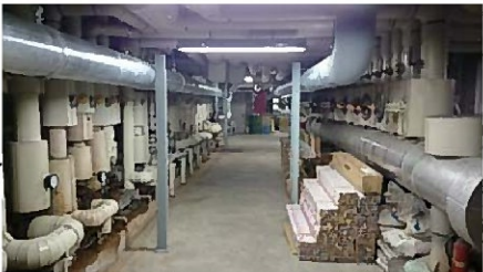
ポンプ室内部
