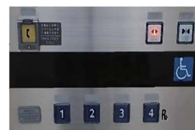
車椅子用エレベータ 操作盤
