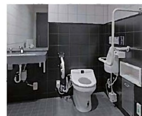
非常用呼出人、オスト メイトのある多目的便所
