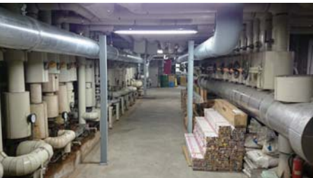
ポンプ室内部
