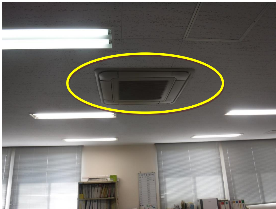
事務室既設空調設備設置場所(写真①)
