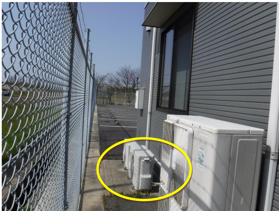
中央監視室既設室外機設置場所(写真④)
